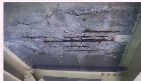
コンクリート床版のはがれ落ち、浮き
