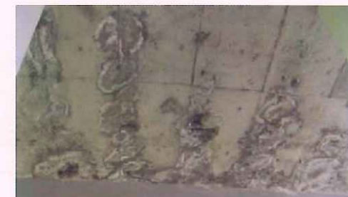
コンクリート床版のひび割れ、遊離石灰の漏出
